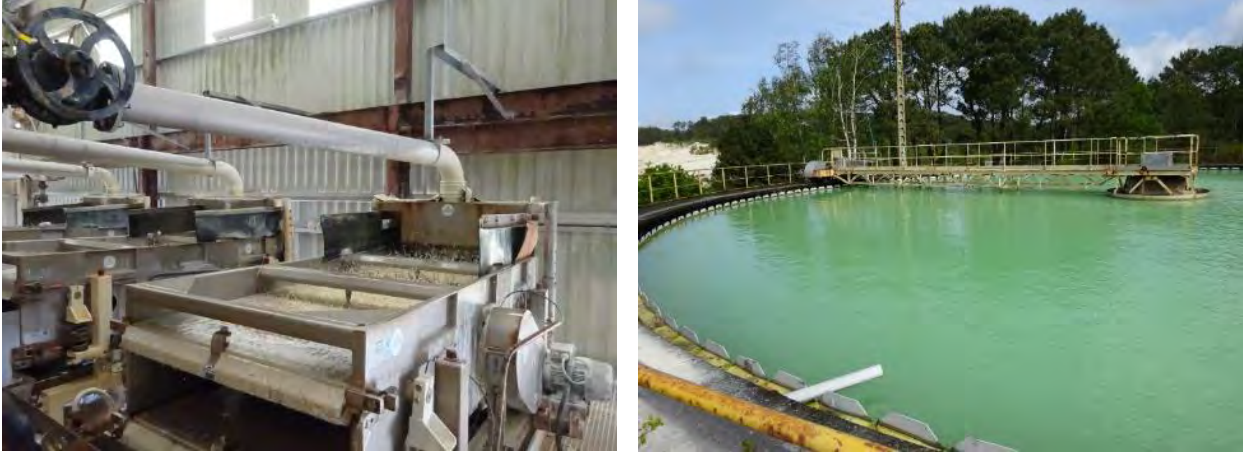
Figure 22 : Etapes du tamisage (à gauche) et de décantation (à droite) – Usine de Kergantic (ENCEM)
