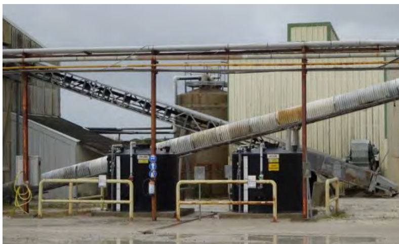
Figure 30 : Stockages de l'acide et de la soude – Usine de Lanvrian (ENCEM)
