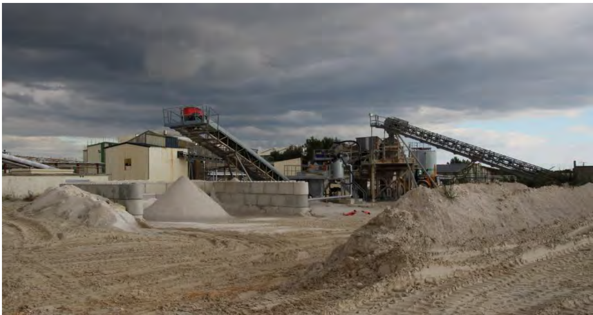
Figure 28 : Installation de traitement de sable – Usine de Lanvrian (ENCEM)
