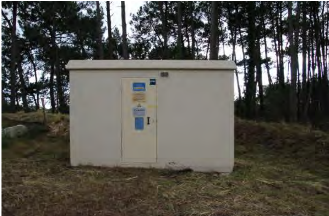
Figure 42 : Poste de livraison Lanvrian (ENCÉM)
