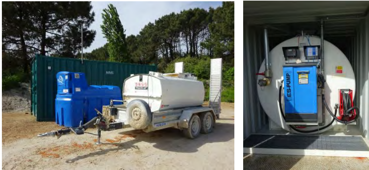
Figure 44 : Cuve de stockage du GNR, cuve d'AdBlue et cuve mobile (ENCEM)
